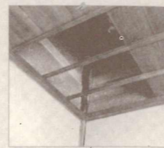
曲がり柱／柱が天井裏に入っ てうねるように変形していま す。変形部分には四方から梁 がささり、大工の腕の見せ場 でもありました。見学者が天 井裏を覗けるように工夫しま した。
